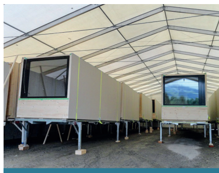
Zwischenlagerung der Module
