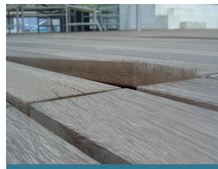
Stolperfalle durch unterdimensionierte Schrauben
