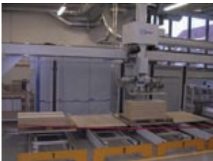
CNC Beschickungsanlage von „Homag“
