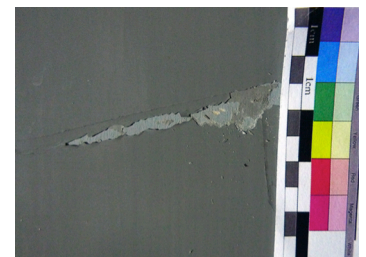
Vorhandene Beschädigungen in der Farbschicht können als Sondagen verwendet werden.
