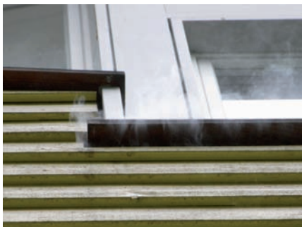
Rauchaustritt aus der Entlüftungsöffnung beweist eine Luftzirkulation in der Hinterlüftung.
