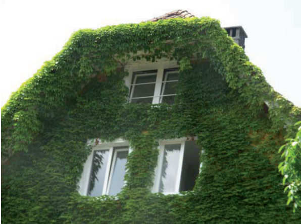
Abb. 1: Pflanzenbewuchs bei einem Gebäude, dies kann zu erheblichen Schäden am Haus führen.
