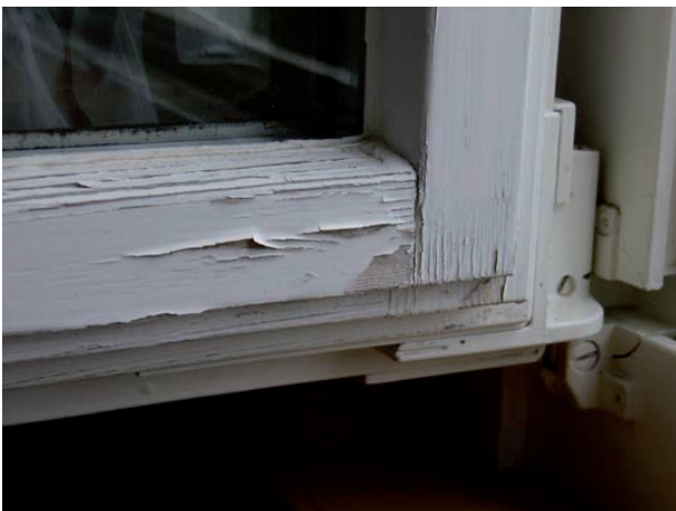
Abb. 2: vernachlässigter Unterhalt eines Fensters
