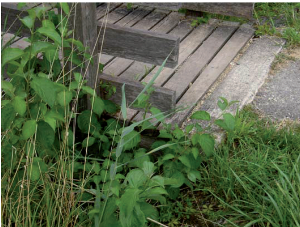
Abb. 3: schlecht unterhaltener Fussgängersteg
