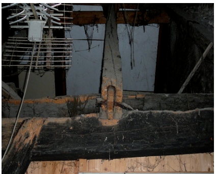
Der jetzige Dachstuhl. Schützenswerte Bausubstanz?
