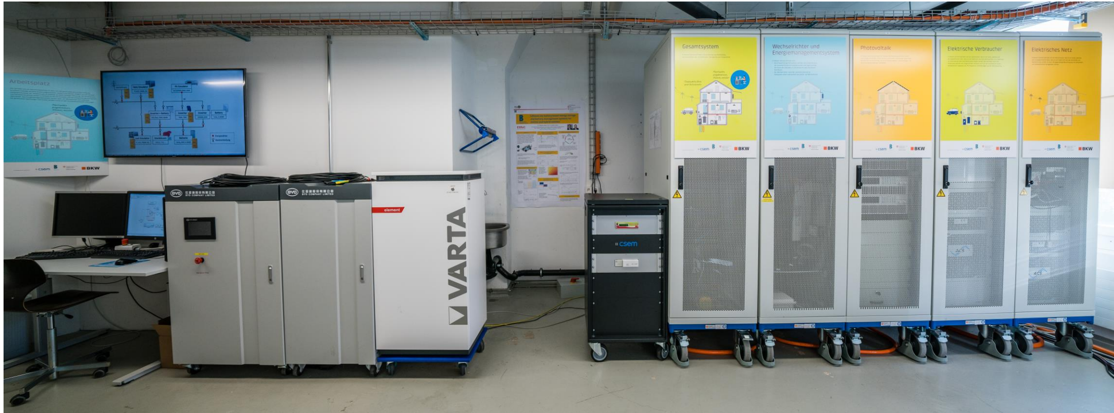
Monitoring Heimspeicher (Lithium-Ionen-Batterien) Energiemanager Prosumer-Haushalt
