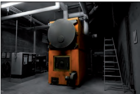
Abbildung 1, eine der bestehenden Heizungen
