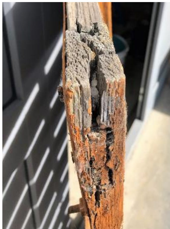
Abb. 372: Defekte Rahmenecke infolge durchgehender, aufrechter Friese. Bei Hirnholz kann Wasser eintreten, durch die dauerhaft erhöhte Holzfeuchtigkeit ein guter Nährboden für holzerstörenden Pilz.
