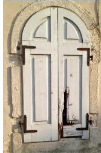
Abb. 66: Laden, verfault im Bereich der unteren Füllung.
