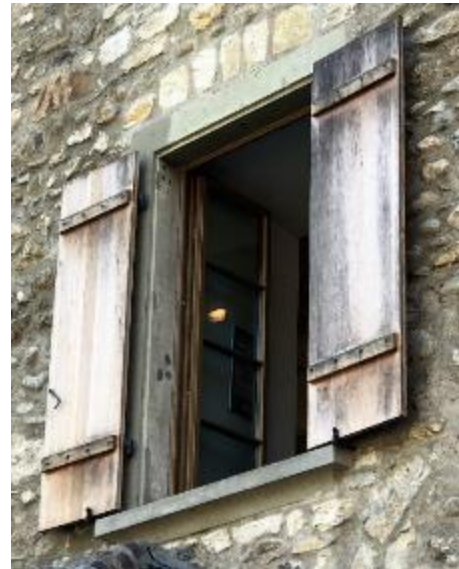
Abb. 374: Schlössli Wörth am Rheinfl. Eichenläden unbehandelt, auf geschützter Nordseite. Gut sichtbar blau-schwarze Verfärbungen durch Gerbsäure.
