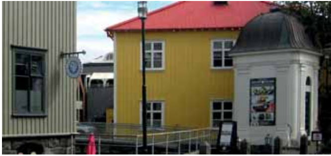
Ein pavillonartiger Trafo in Reykjavik. Der neoklassizistische weiße Trafo hat pilasterartige Ecklisenen und eine walmdachartig geschweifte Dachhaube aus Metall. Ein Kranzgesims verbindet die Lisenen knapp unterhalb des Daches. Auf der tannengrün gestrichenen Eingangstüre ist das gelbe Blitzzeichen – das international verstanden wird – angebracht (Foto von 2013).
