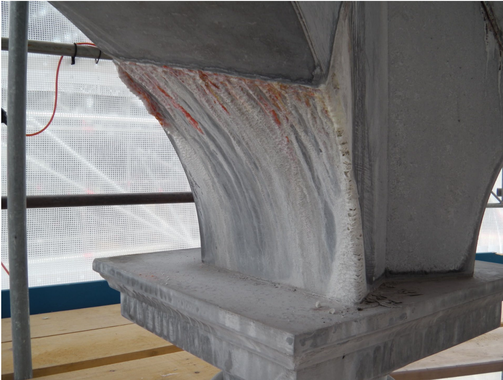
Abb. 118 Vorbefund Dachbereich des Frauenbrunnens 2013: Kalkaussinterungen, welche mit dem Eisen vom Stein (Pyrinäenalk) entfernt werden mussten. Die orangenen Stellen sind chemische Reaktionen.
