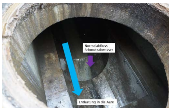
Regenüberlauf RA74: Bei starken Regenereignissen wird das überschüssige Wasser in die Aare abgeleitet.
