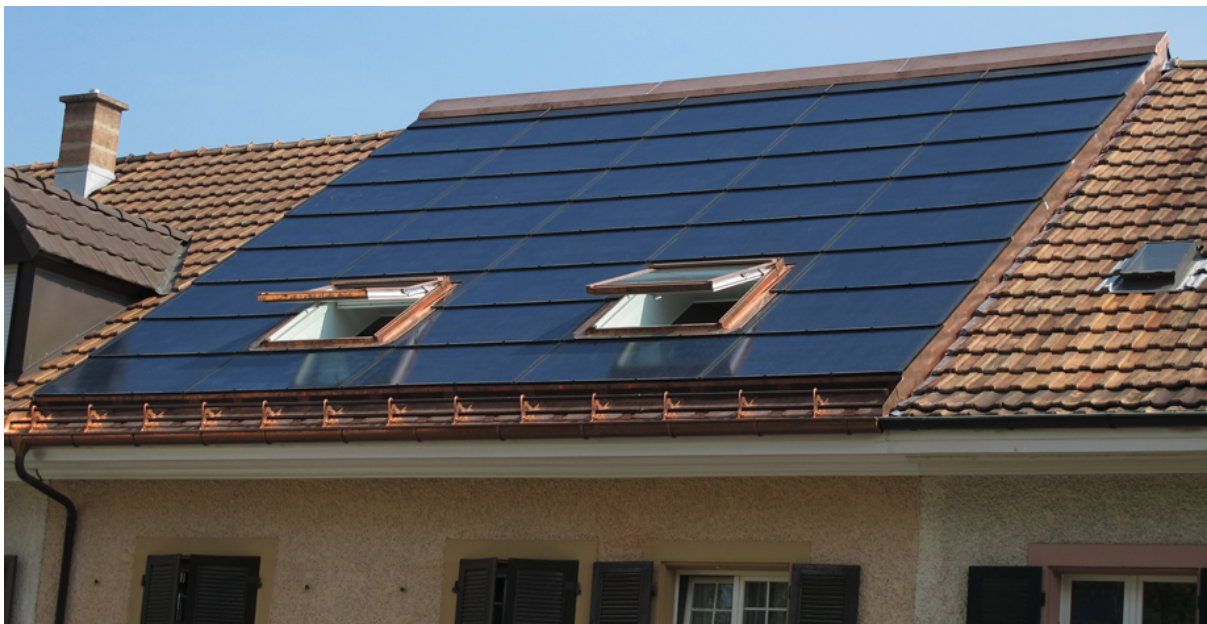
Abb. 43, Ganzdachanlage als Indachanlage ausgeführt
