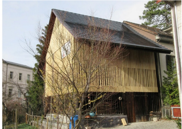
Abb. 86, Dach mit PV-Indachanlage
