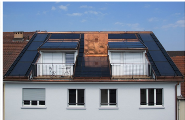
Abb. 45, Ganzdachanlage mit PV- und Solarmodulen
