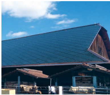
Abb. 54, Indachanlage auf Ökonomiegebäude
