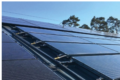
Abb. 19, PVT-Modul als Aufdachanlage
