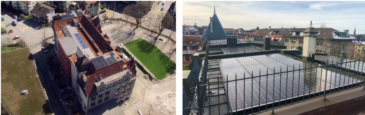
Abb. 41 und 42, Photovoltaikanlagen auf den flachen Dächern der Mansarddächer
