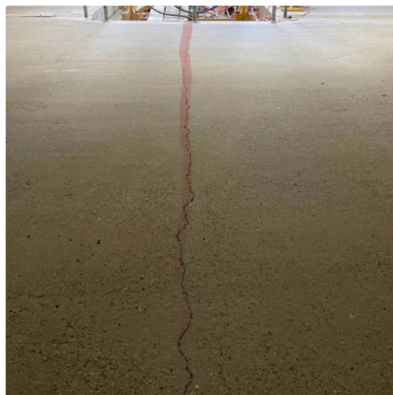
Praxisbeispiel Rissbild bei der Kранаussparung
