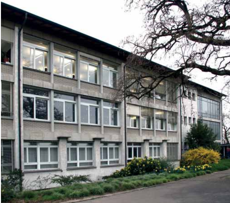
Bild 54: Schrägansicht Hauptfassade, 2014: Muraler, verputzter Sockelbereich, die verputzten Hauptstützen werden mit einer überdimensionierten Kopfplatte nach oben abgeschlossen. Sturzverkleidungen und Zwischenstützen als Betonelemente, Ausfachung der Brüstungen in Kalksandstein, Schiebefenster in Holz, weiss gestrichen. Nebenraumbereiche mit kleinmassstäblichen Lochfenstern, Treppenhaus mit grossflächiger Verglasung
