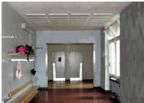
Bild 119: Korridor mit bauzeitlichen Decken-Akustikplatten, 2014. Ursprüngliche Farbigkeit der Korridore unklar. Holzfenster mit Drehflügel und Klappflügeln im oberen Bereich
